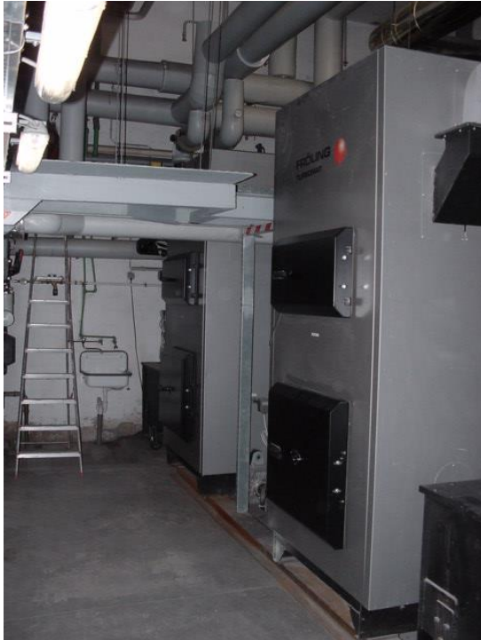
Heizkesselanlage 2 x 500 KW
